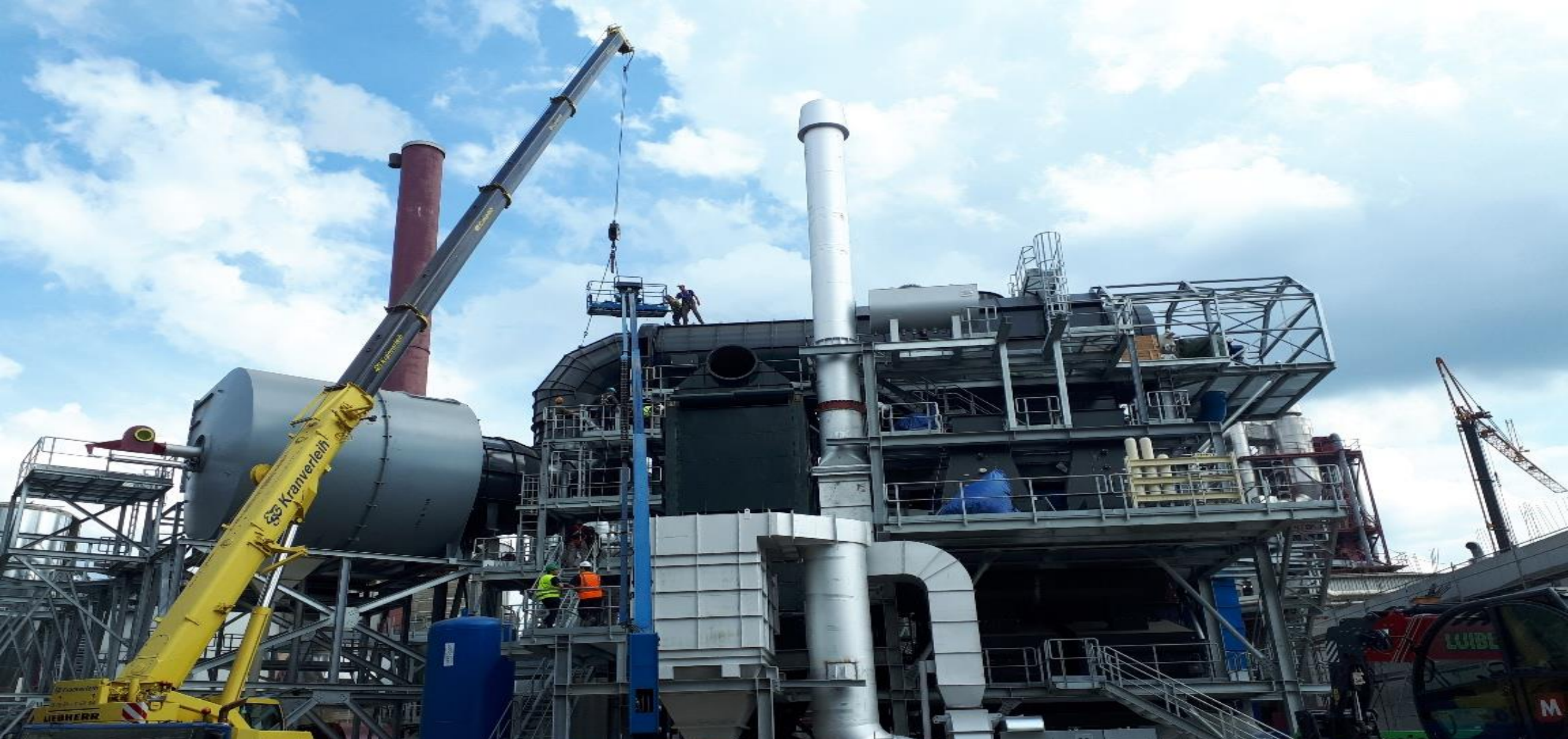
INŠTALÁCIA KOTLA, PFLEIDERER, NEMECKO
